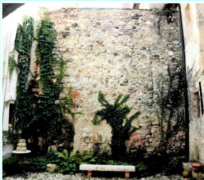
Slika B45. Zid med Magušarjevo in Vidičevo hišo.
