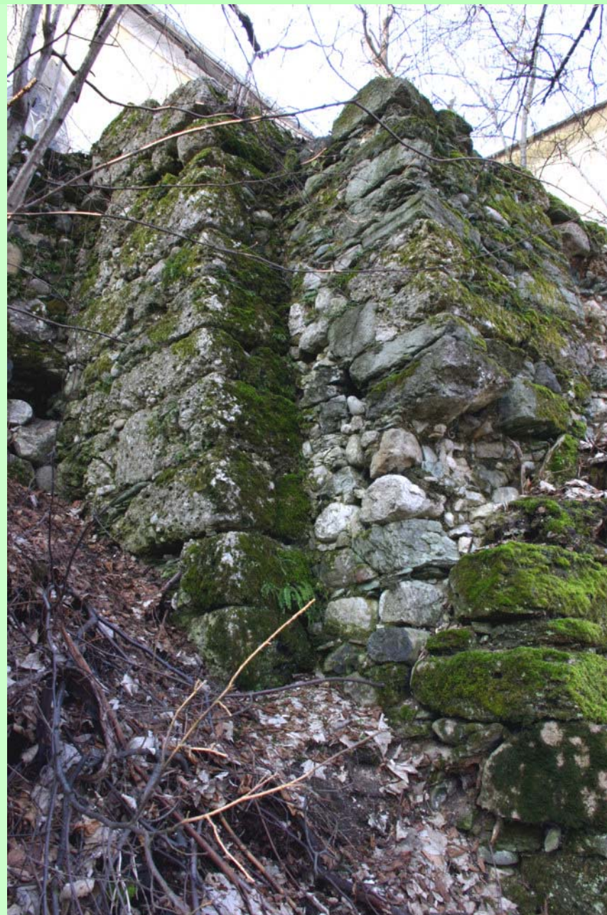
K staremu podporniku dozidani novi, ki je nosil hodnik pred obrambnim zidom.
